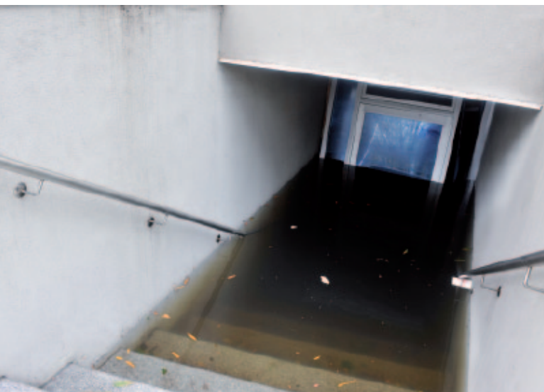
Abb. 5.19: Beispiel eines tiefliegenden, überfluteten Gebäudezugangs.
