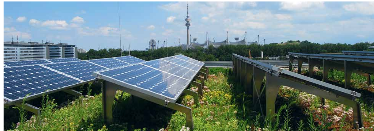
ABBILDUNG 3.2–6 ▶ Photovoltaik-Aufdachanlage mit Dachbegrünung, Münchner Technologie Zentrum. (Foto: ZinCo GmbH, 2011)
